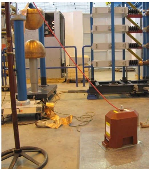
obr. 3 Skúška atmosférickým impulzom na primárnych svorkách PTN
